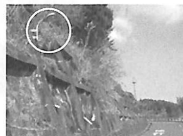
【⑨設置場所（丸印が外灯）】
