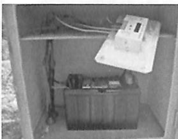
【⑪ボックス内部】 （充放電コントローラとバッテリー）
