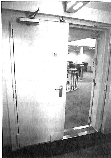
▲写真5 通路から公室（階段室）への段差のない 出入口（A60級防火扉） (M船)
