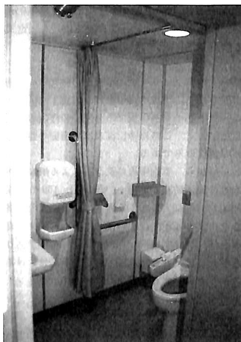
▲写真6-2 身体障害者用トイレ設置例 (F船)
