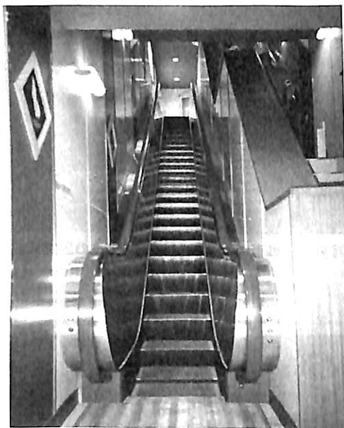
▲写真4 旅客フェリーの代表的なエスカレータ 設置例 (K船)
