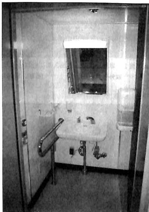
▲写真6-1 身体障害者用トイレ設置例 (F船)
