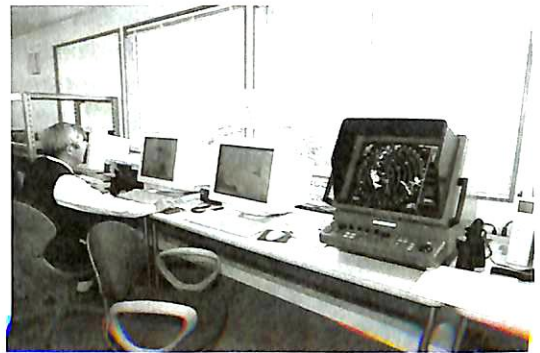
▲ 情報管理センター内に設置された 監視レーダ指示部
