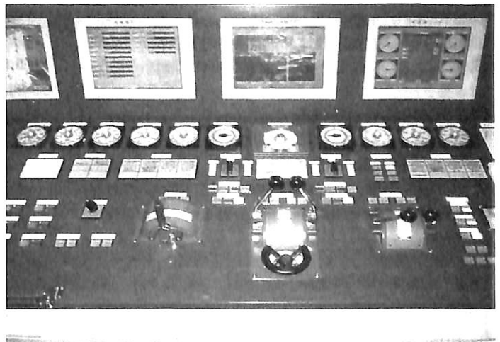
▲ 自動制御総合システム盤面
