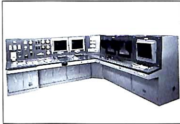
エンジンコントロールコンソール
