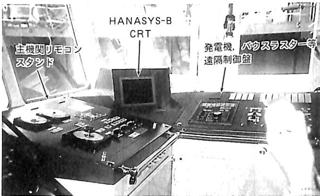
▲ 主機、発電機、バウスラスタ、遠隔制御盤
