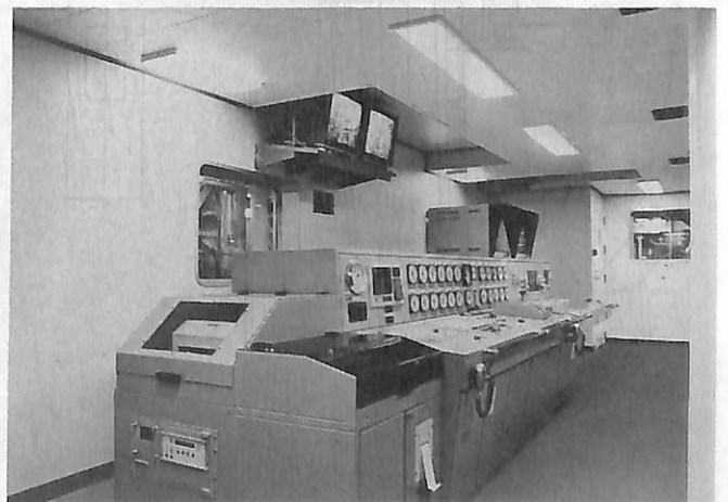
▲ 機関制御室（その1）
