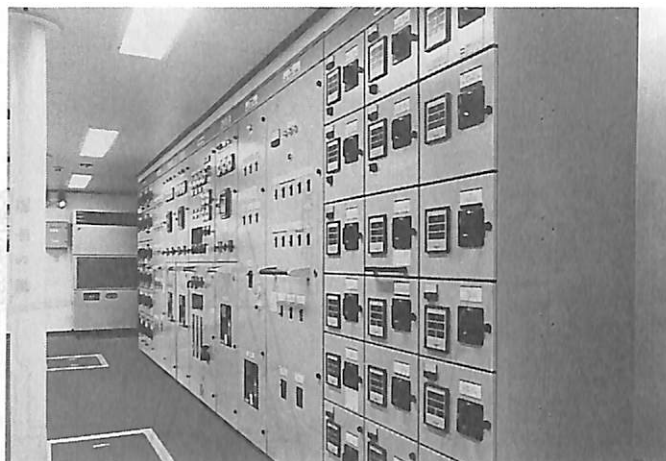
▲ 機関制御室(その2)
