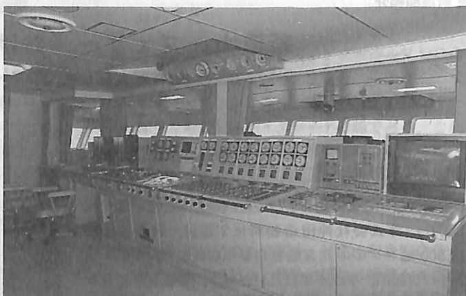
▲ 操舵室内の主機関制御室 (航海船橋甲板)
