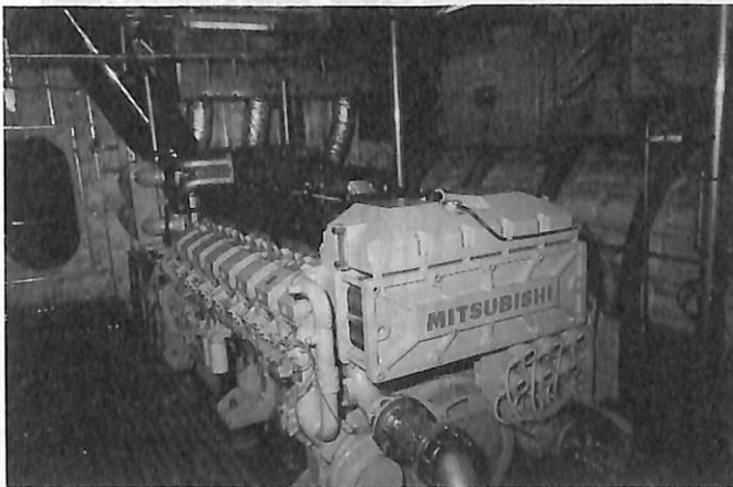
▲ 写真-5 主機関 (右舷1号機)
