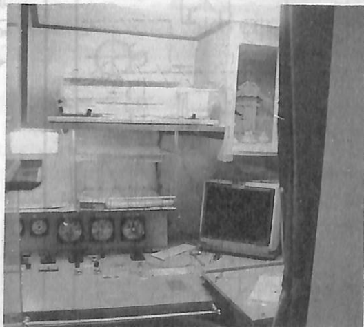
▲ 機関遠隔操縦盤
