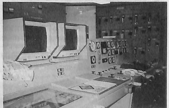
▲ エンジン制御室
