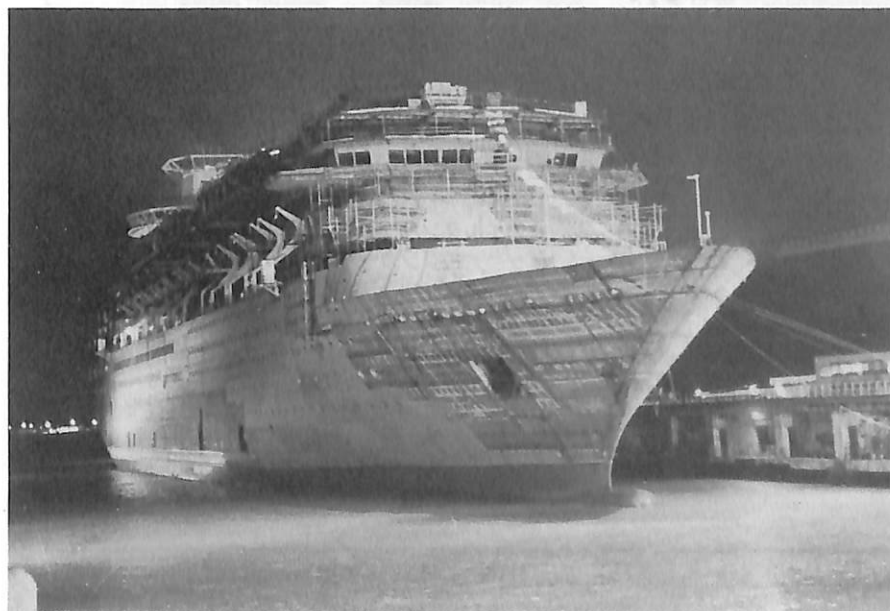
◀ 1990年9月20日 初浮上(進水)し、艀装 岸壁に係留された “MONARCH OF THE SEAS”
