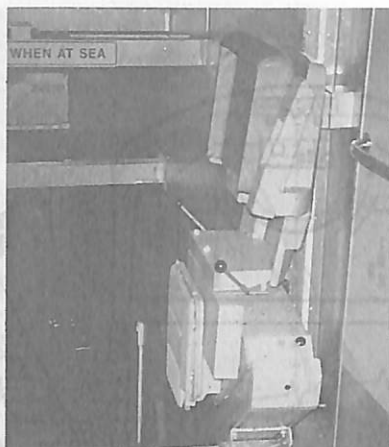
▲身体障害者用リフト
