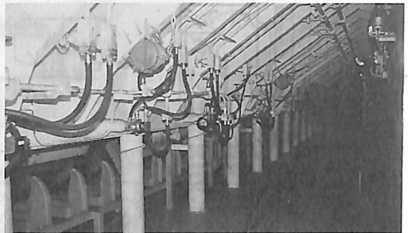
▲トンネル・アウター・ループ・ベルト・コンベア
