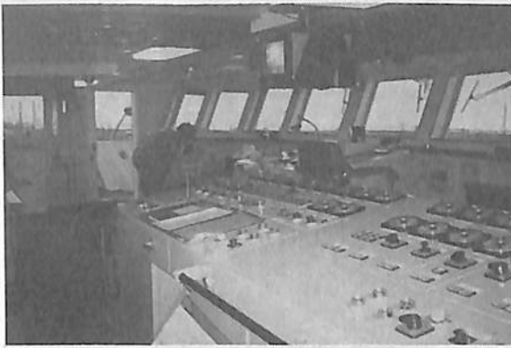
▲操舵室：手前の主機，発電機コンソールと その向うにメイン操縦台を見る。
