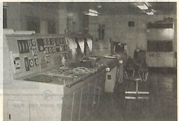
▲ 機関制御室コンソール
