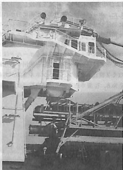
S/V "A" フレームとブームコンベア基部
