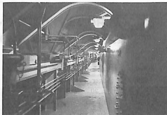
S/V ホールドコンベアトンネル
