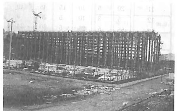
完成したコンテナ用シャーシー立体格納設備
