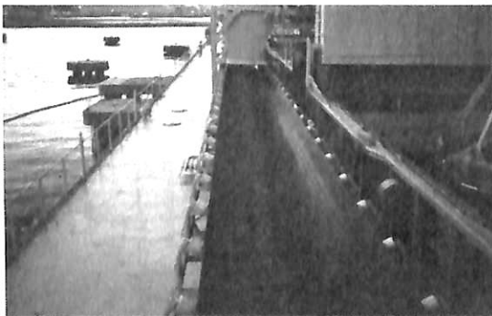
右舷No.1 コンベア (チップ搬送中)
