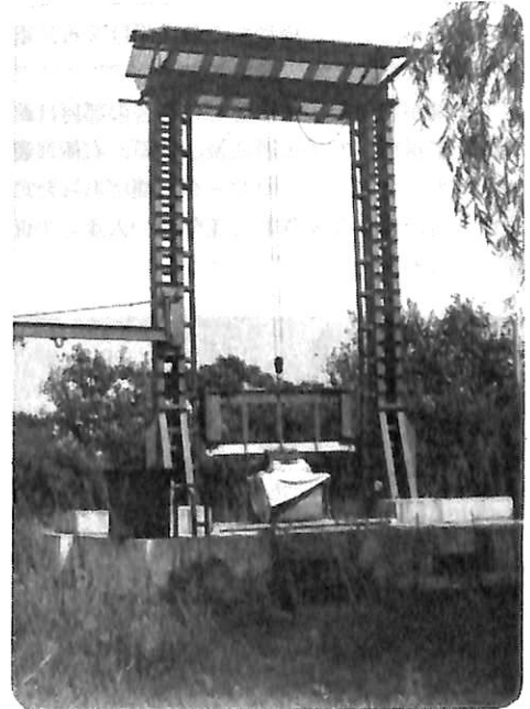
写真5 スラミング水槽
