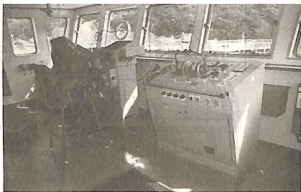
操舵室 (主リモコン・レーダー・操舵スタンド)
