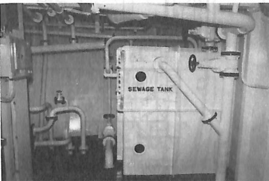
左舷上甲板に据付けられた汚水処理タンク
