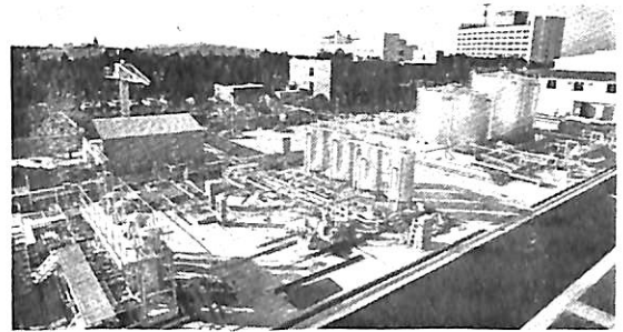
写真6・4 排水処理施設 (左手前は第2次油水分離装置, 中央は浄化殺菌循環装置, 右手奥は油水タンク, 左手奥のジブクレーン附近は供試体等の洗浄装置)
