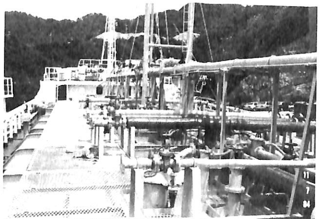
整然と配置配管された荷油管, CO 2 , 消防管, ヒーティングコイル, エヤイベント管など
