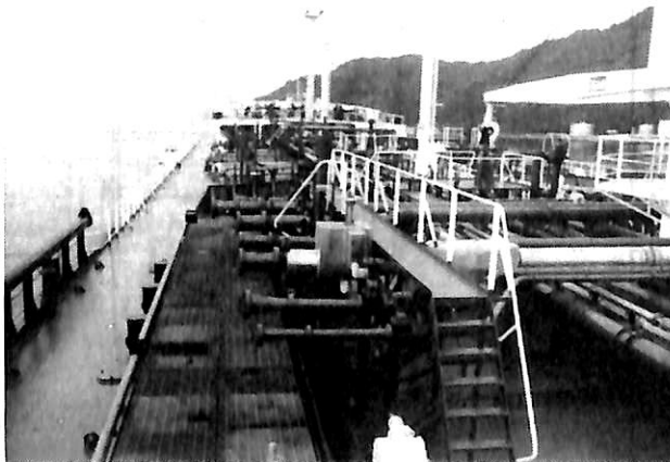
カーゴオイル ショア マニホールド
