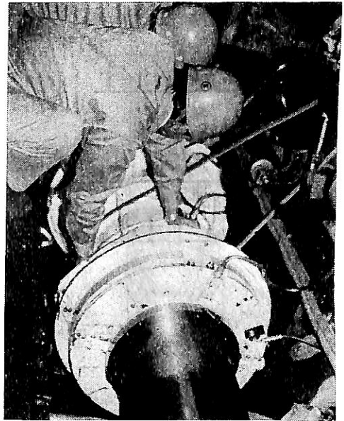
写真1 実船の中間軸に取り付けた軸出力計検出器
