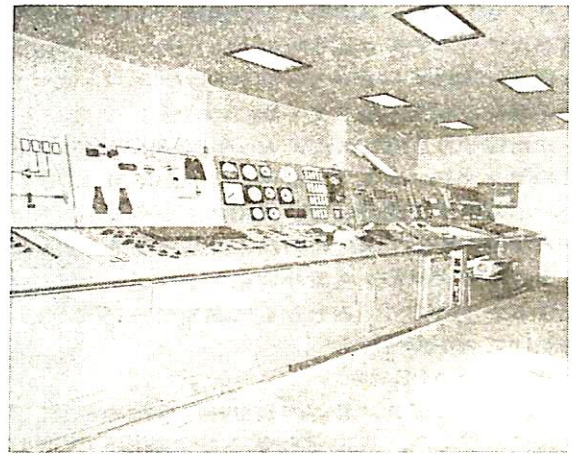
機関制御室監視盤
