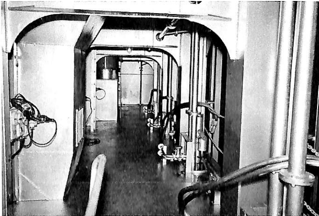
冷凍コンテナ艙のプラットフォーム
