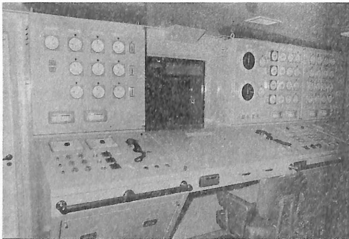
機関室監視盤
