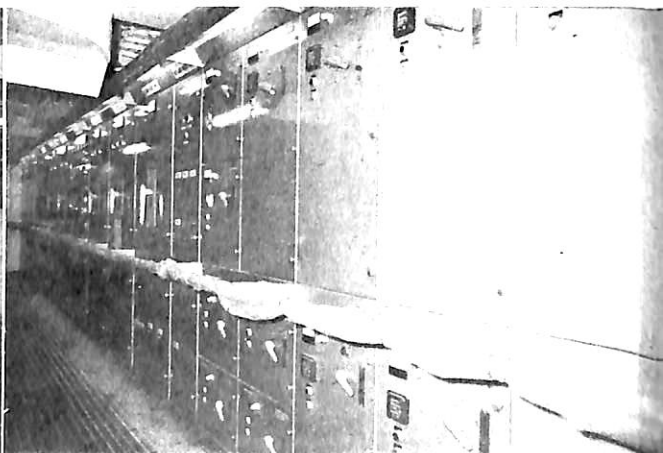
主配電盤（手前の部分が集合起動器盤となっている。さらにこの手前の写真には見えないところに440Vフィーダー・パネル、蓄電機・パネルがある）
