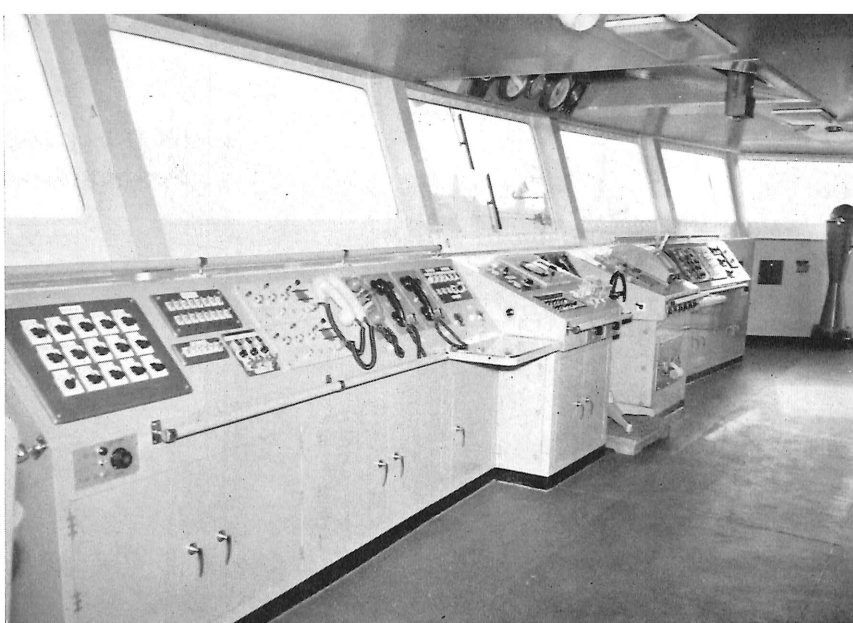
操舵室内部の コンソール配置
