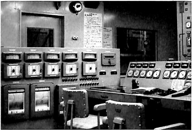
機関部制御室内部 (1)
