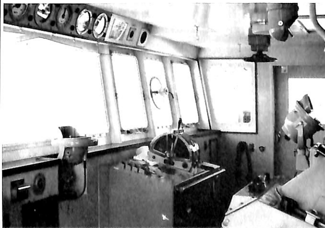
操舵室内の主機操縦装置
