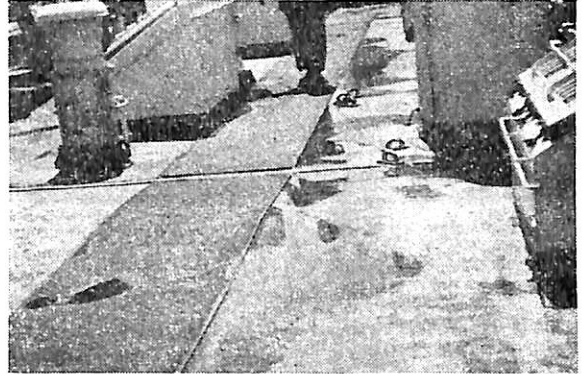
写真 12.3(A) 十和田丸端艇甲板の水たまり (新造時)
