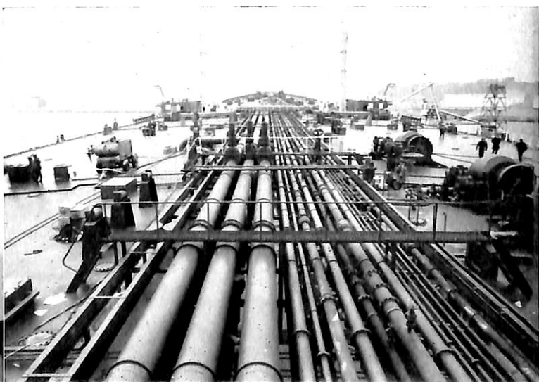
上甲板パイプライン
