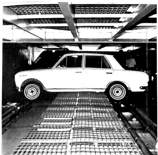
オートシフターによる自動車格納状況
