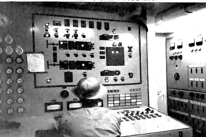
機関部監視室
