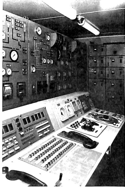
→ エンジン コントロール室内
