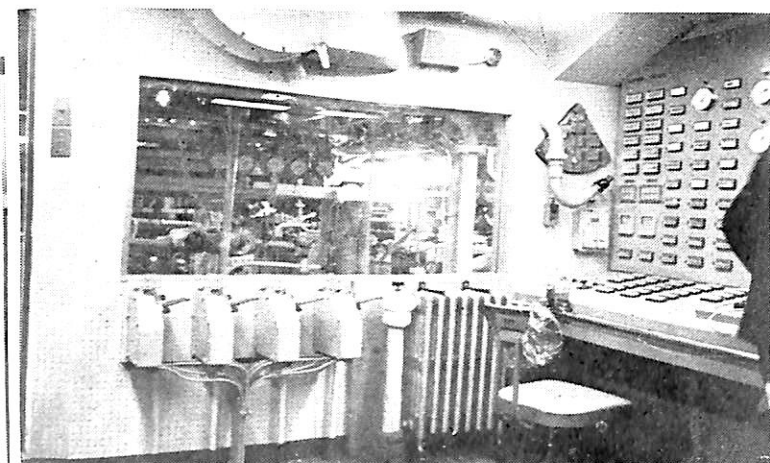
管制室内部主要補機起動器（窓より機関室がみえる）
