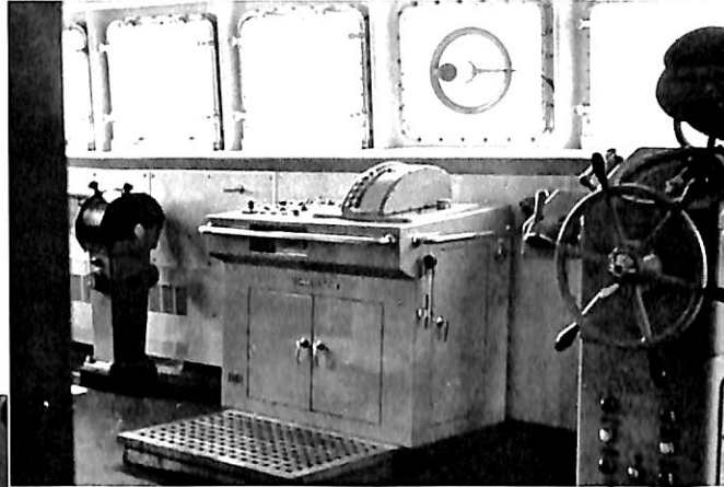
船橋コンソール (操舵室)
