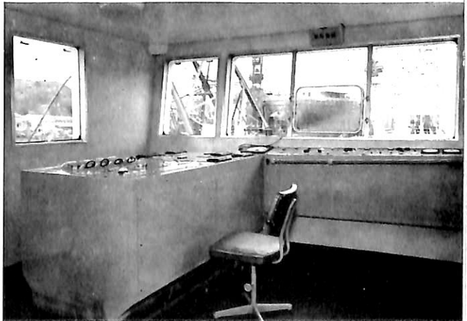
⑱ ヒーリング装置の一部 (ポンプ操縦室) (写真20)
