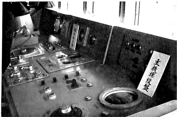
船橋操縦室の主機操縦盤や各種監視装置
