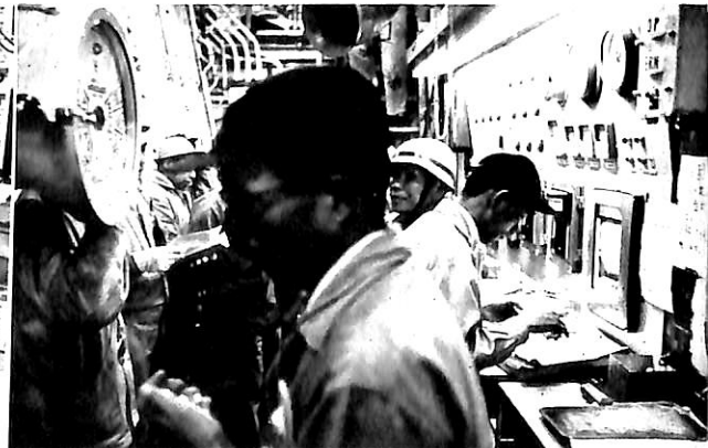
機関室内の計器盤
