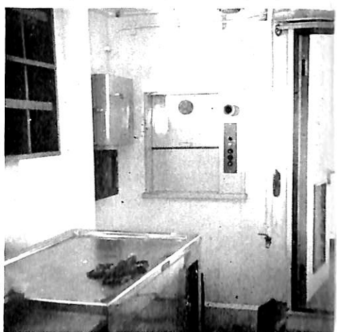
Galley-Pantry 間のリフト (Pantry 側出入口)
