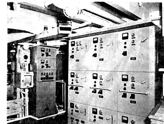
写真 7 冷凍機用集合起動器盤
